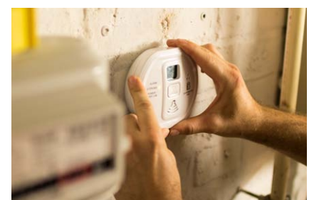
Ein CO-Warnmelder sollte bspw. im Heizungskeller oder am Kamin installiert werden.
