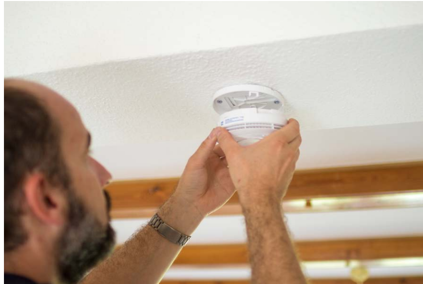
Kleiner Aufwand, große Wirkung: Rauchmelder sind nicht teuer und sehr einfach zu installieren.
