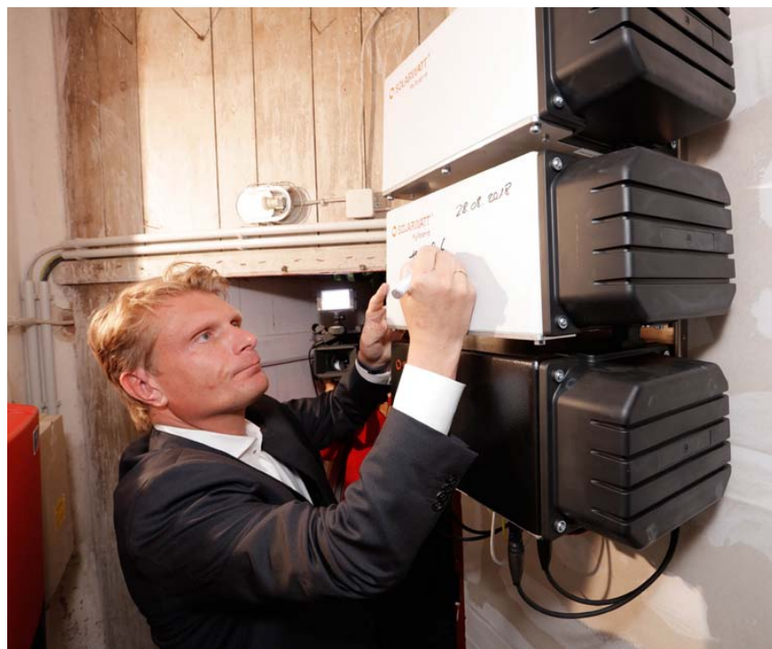
Solarspeicher können modular je nach Anlagenleistung im Keller des Eigenheims installiert werden. Foto: Bundesverband Solarwirtschaft e.V. (BSW)
